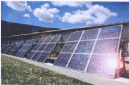
Panneaux solaires de l'Institut national français de l'Energie solaire © INES - photographie : G.Cottet
